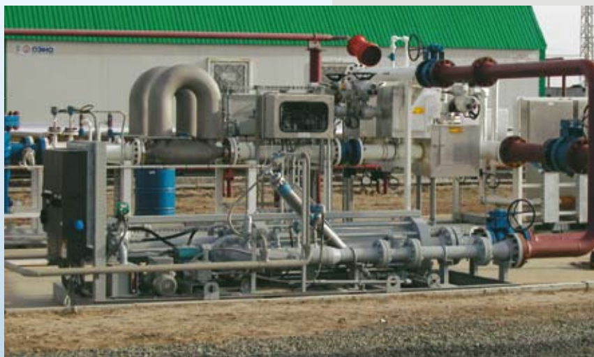
Поверка кориолисового расходомера с помощью компакт-прувера на основе измерения массового расхода
